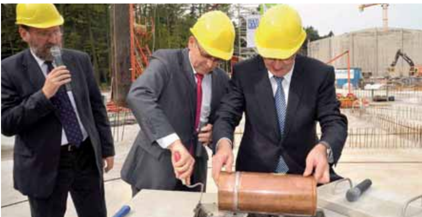
Ministerpräsident Erwin Sellering (li.) und Oberbürgermeister Roland Methling (re.) mauern die Glückskapsel in den Grundstein ein (li. Zoodirektor Udo Nagel). Fotoquelle: Zoo Rostock/Joachim Kloock
