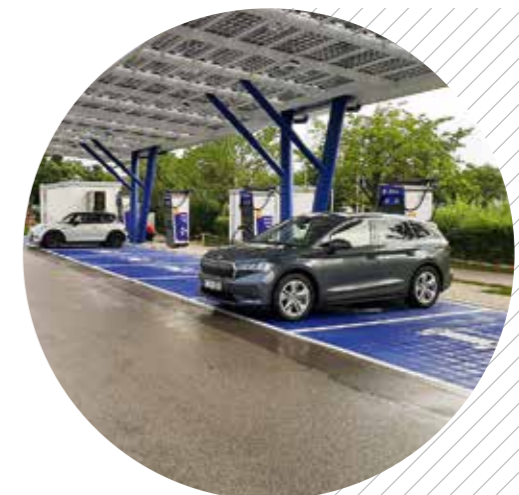
Ladehub für EnBW Schnellladepark mit 20 HPC (High Power Charging)
